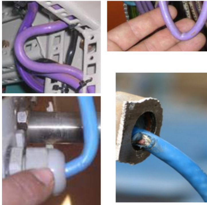
Figura 3 - Exemplos de Curvaturas Mínimas Inadequadas e de Cabos Danificados
